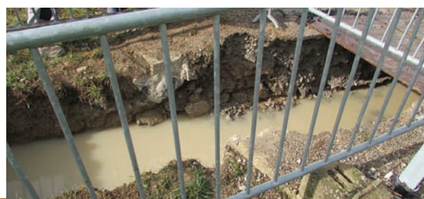
Eaux pluviales Tauléac ►
